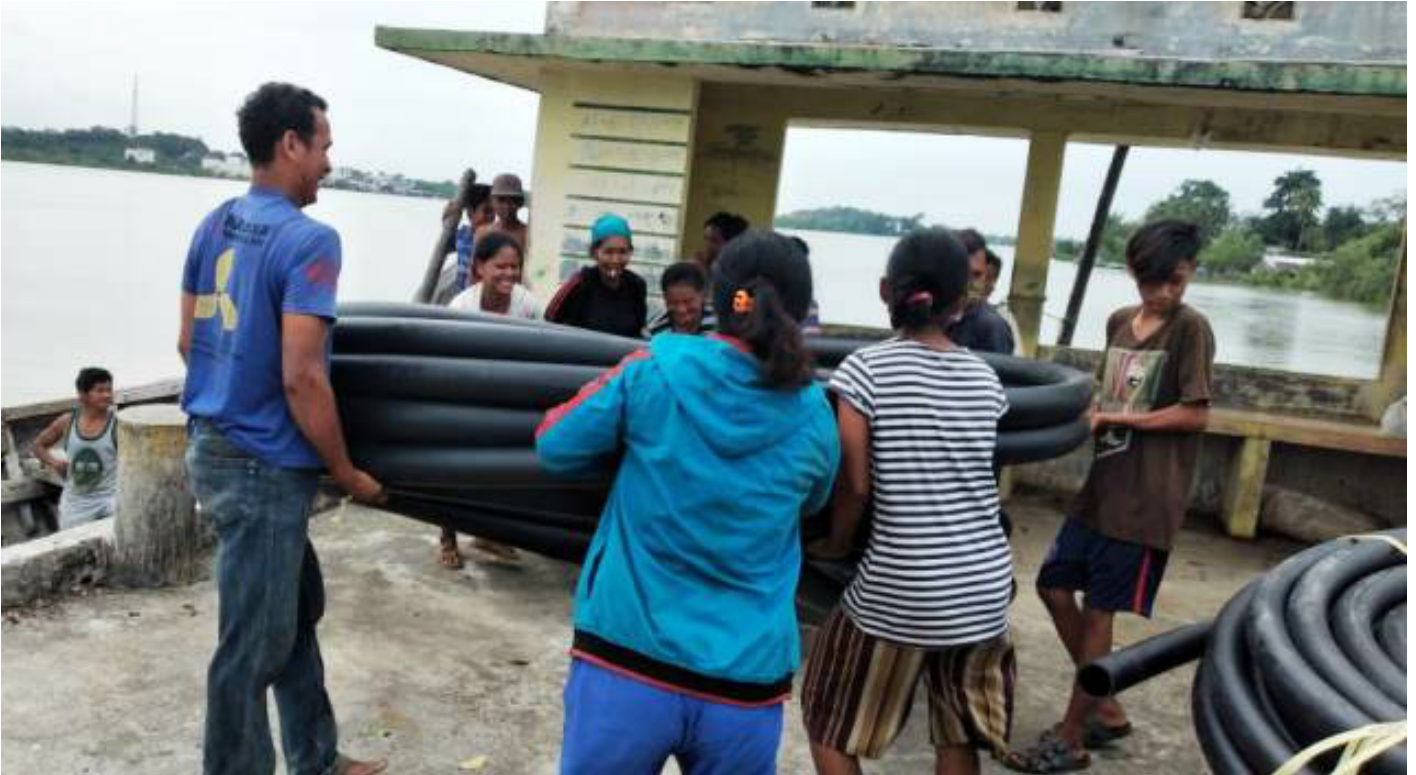
Foto: Kaum perempuan Suku Laut di Desa Sebele, Kecamatan Belat, Kabupaten Karimun, Kepulauan Riau, ikut aktif dalam kegiatan fisik pembangunan sarana air minum perdesaan Pamsimas dengan membantu mengangkut bahan material, seperti kabel dan perlengkapan lain.
