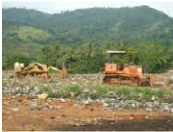
Gbr. Peralatan Pengolahan sampah di TPA Padang
